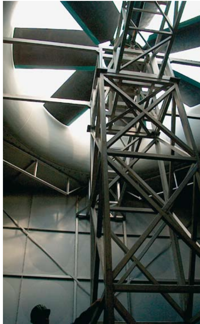
Skelet en ventilator van de koeltoren van binnenuit gezien
