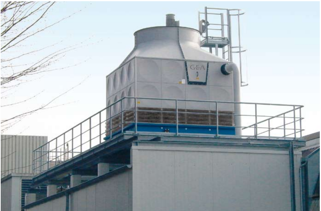
CMC koeltoren type 16 Levensmiddelenfabriek in Duitsland
